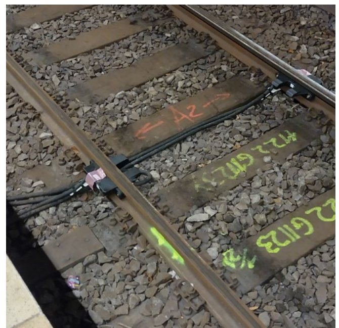
Bild 1: Verkabelte redundante Achszählpunkte
