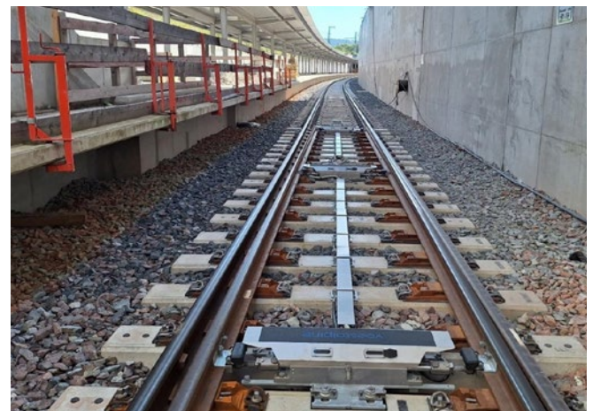
Bild 3: Hydraulischer Weichenantrieb an der Station Mitnachtstraße (Bauzustand September 2023)
