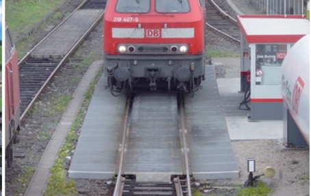
Auffangsystem an Tankanlagen
